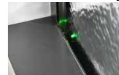
Detailbild: Elektronischer Wasserstandsanzeiger
